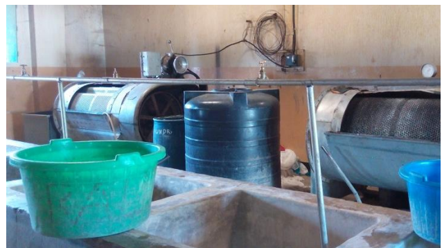
Bildlegende: Das Wasser für die Waschmaschinen wird noch über dem Feuer erwärmt
