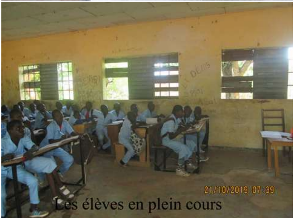
Salle de classe avec des fenêtres détruites
