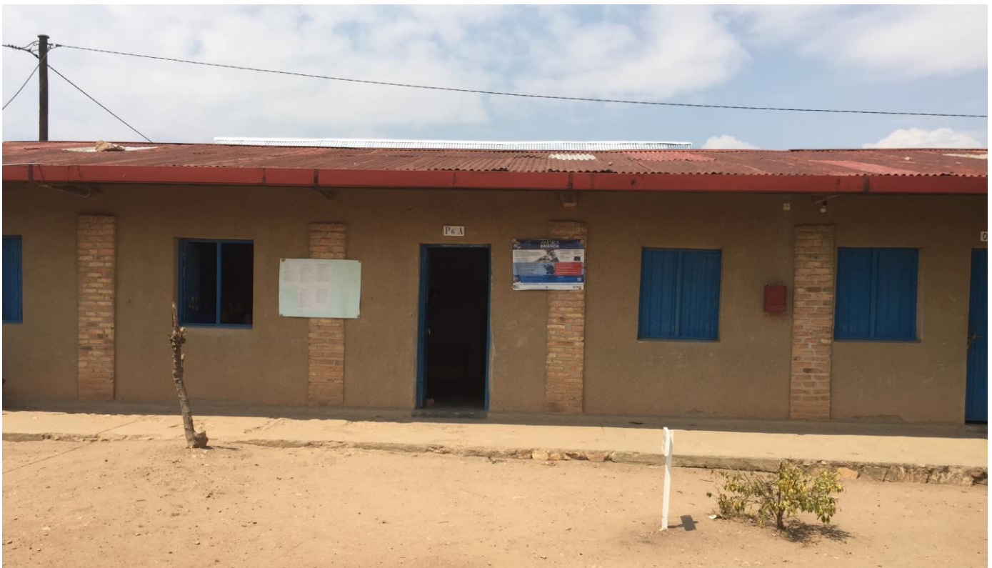
Jedes Schulzimmer hat die gleiche Grösse von: 7x9m, eine Tür und 2 scheibenlose Fenster. Der Informatikraum erhält Scheiben und die Fenster werden höher liegen: ca. 2 mal 2x0.5m pro Seite..
